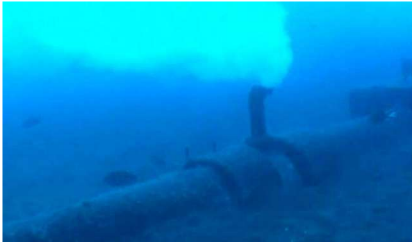
Figura 1 – Difusor do emissário submarino do polígono industrial do Valle de Güímar, Espanha.
